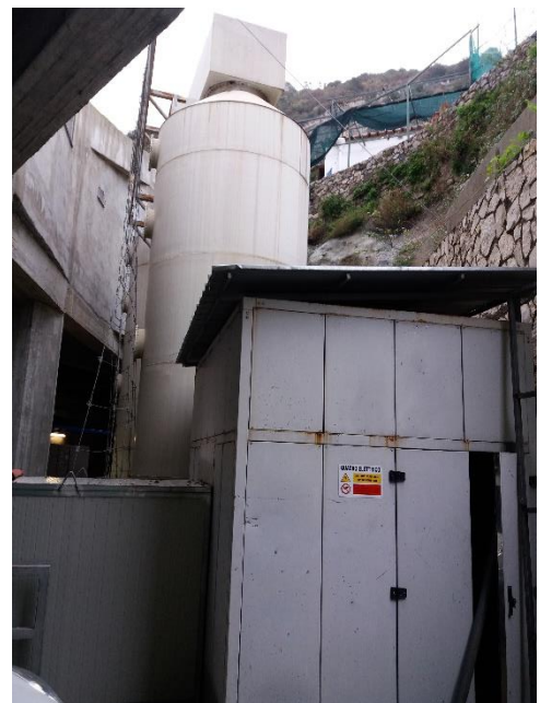
Figura 30. Impianto Positano. Impianto trattamento aria.
