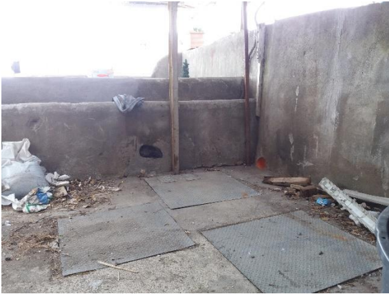
Figura 30a. Impianto sollevamento Marina Positano.
