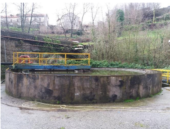
Figura 14. Impianto Agerola. Linea liquami. Sedimentazione.
