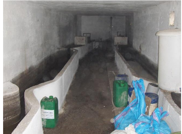
Figura 67. Impianto Ravello Marmorata. Sui lati i canali di dissabbiatura.
