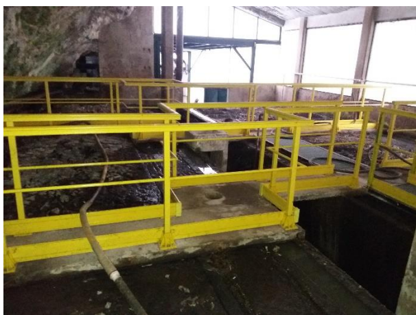
Figura 81. Impianto Minori. Sedimentazione primaria e digestione anaerobica.
