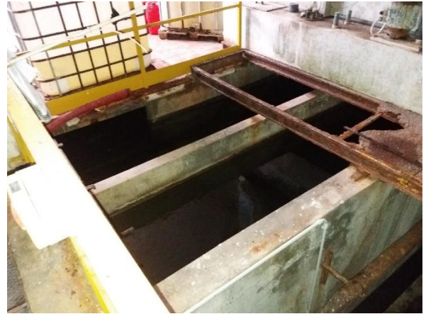
Figura 83. Impianto Minori. Disinfezione.
