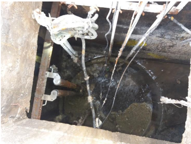
Figura 55c. Atrani Piazzale Marinella. Vasca di carico e rilancio a via dei Dogi (livello -1) munita di sfioro.
