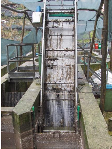
Figura 87. Impianto Tramonti. Grigliatura
