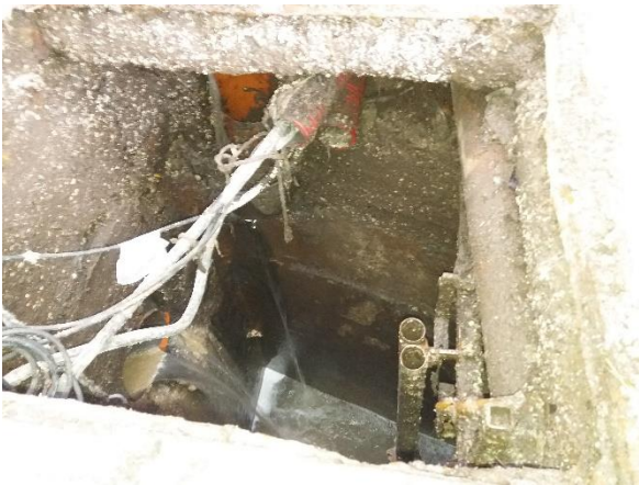
Figura 30c. Impianto sollevamento Marina Positano. Dettaglio pozzetto lato monte.
