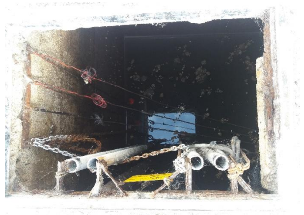
Figura 101d. Minori. Erchie. Vasca raccolta reflui e pompaggio in condotta sottomarina.
