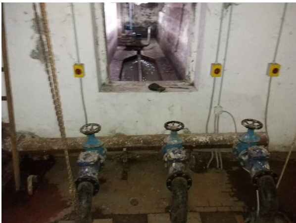
Figura 79. Impianto Minori. Sollevamento liquami dalle fasi di trattamento primarie ai rotostacci.
