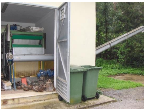
Figura 93. Impianto Tramonti. Nastropressa (inutilizzata).
