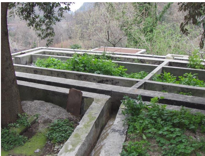
Figura 62. Impianto Ravello Cigliano. Vasca Imhoff.
