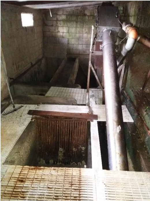
Figura 39. Impianto Praiano – Loc. Torre. Grigliatura-dissabbiatura.
