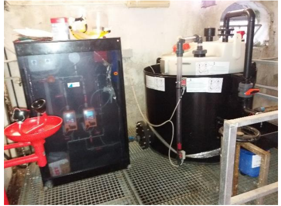
Figura 51. Impianto Amalfi. Disinfezione.
