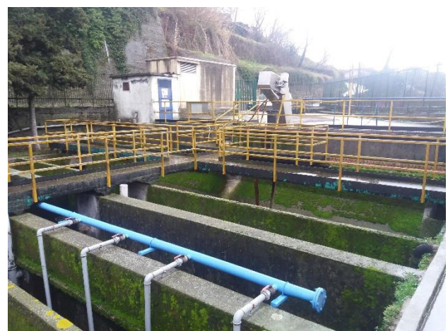
Figura 9. Impianto Agerola. La prima vasca (in alto) è inutilizzata mentre nella seconda (in basso) avviene la SBR.
