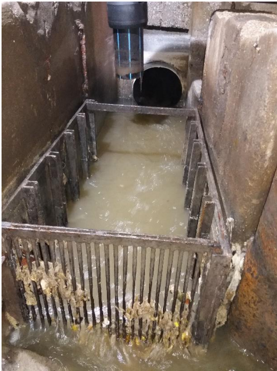
Figura 57a. Impianto Atrani via dei Dogi. Ingresso reflui e grigliatura (livello -1)
