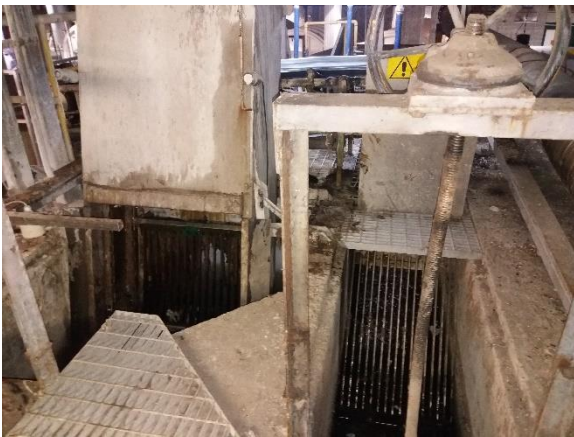
Figura 21. Impianto Positano. Grigliatura.
