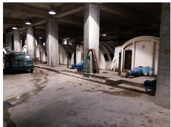
Figura 24. Impianto Positano. Biodischi.
