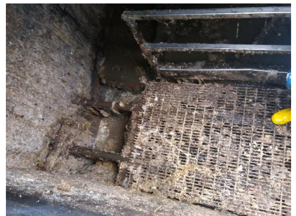
Figura 55d. Impianto Atrani Piazzale Marinella. Grigliatura.
