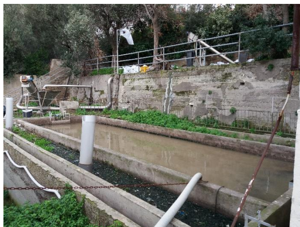
Figura 35. Impianto Praiano – Vettica Maggiore. Sedimentazione.
