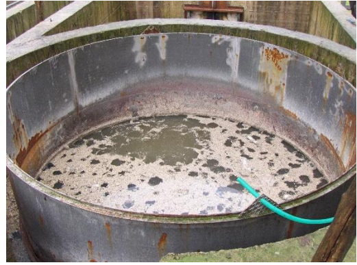
Figura 88. Impianto Tramonti. Dissabbiatura e disoleazione.
