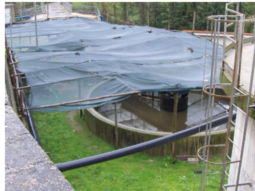
Figura 90. Impianto Tramonti. Sedimentazione.
