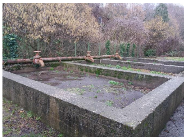
Figura 15. Impianto Agerola. Linea fanghi. Letti di essiccazione.
