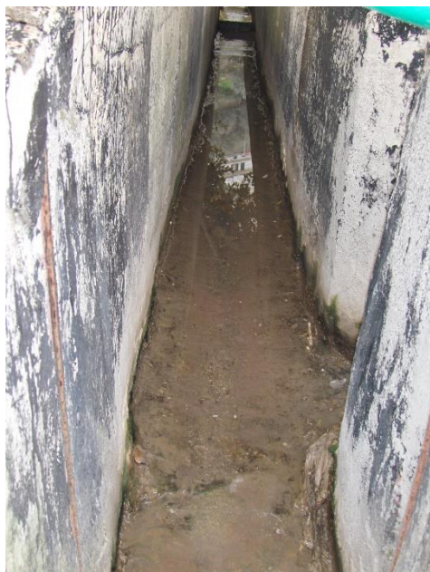
Figura 64. Impianto Ravello Cigliano. Sfiatore, troppo pieno posto nel canale di dissabbiatura. In caso di piogge eccessive i reflui sono scaricati tal quali nel torrente Dragone.
