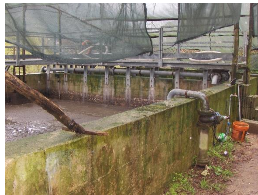
Figura 92. Impianto Tramonti. Linea fanghi. Ispessimento fanghi, ossidazione biologica.
