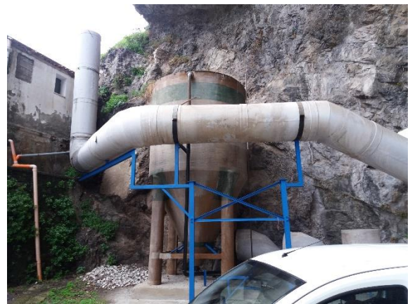
Figura 85. Impianto Minori. Ispessimento fanghi.
