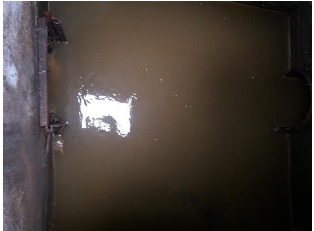
Figura 58b. Impianto Atrani via dei Dogi. Vasca di dissabbiatura (livello 0).
