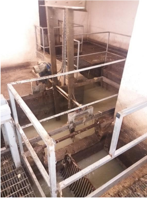
Figura 107. Vietri. Ingresso impianto. Grigliatura.
