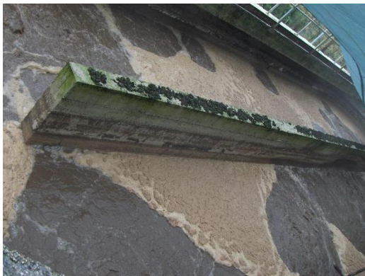
Figura 89. Impianto Tramonti. Vasche di ossidazione.
