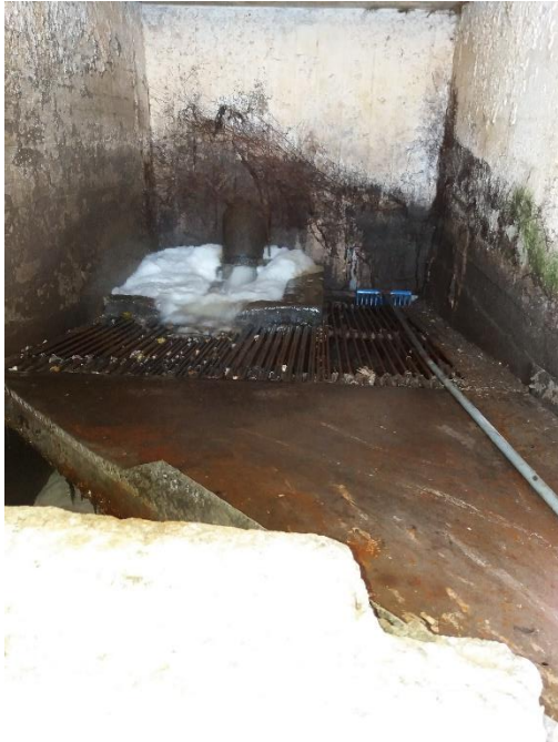
Figura 70b. Impianto Ravello Marmorata. Gabbiotto posizionato in loc. Marmorata a valle della strada statale. Nel gabbiotto è presente la vasca di raccolta dei reflui pretrattati che li immette in condotta sottomarina.
