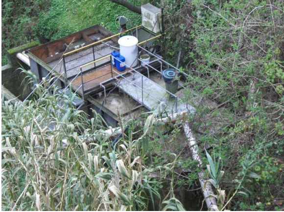
Figura 72. Impianto Ravello Sambuco. Panoramica impianto.
