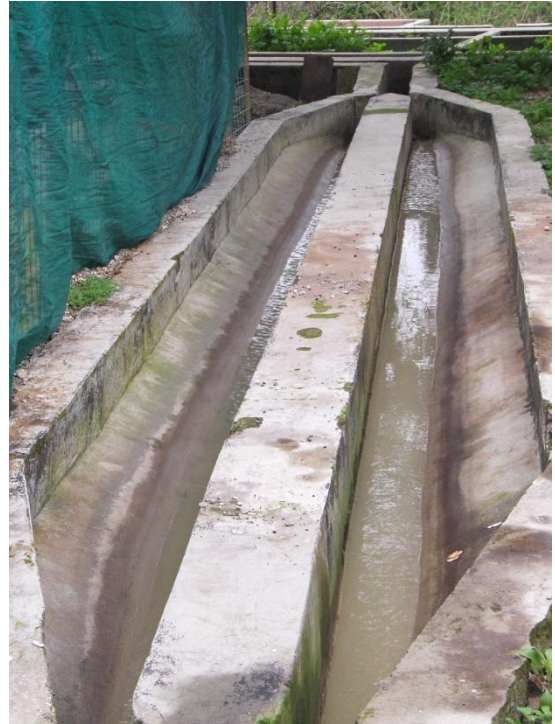
Figura 61. Impianto Ravello Cigliano. Canali di dissabbiatura.
