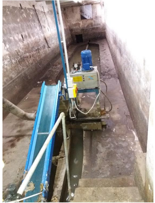
Figura 78. Impianto Minori. Grigliatura automatica e canali di dissabbiatura.
