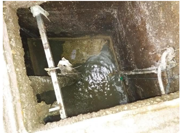
Figura 30b. Impianto sollevamento Marina Positano. Dettaglio pozzetto lato mare.
