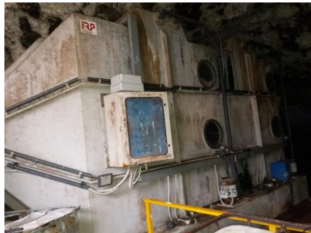
Figura 85b. Impianto Minori. Impianto trattamento aria. Non funzionante.
