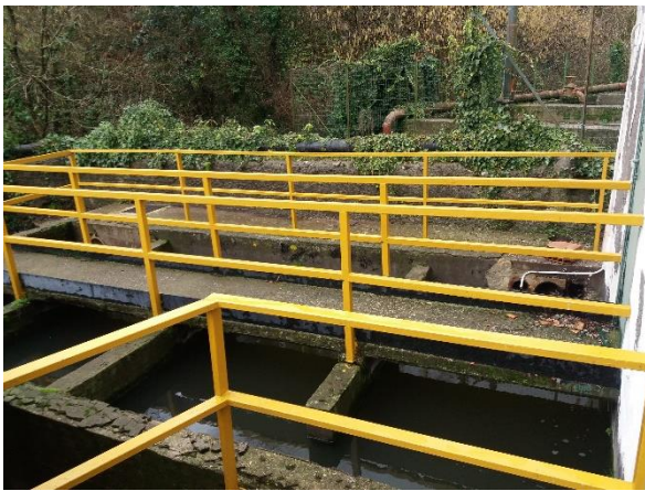
Figura 12. Impianto Agerola. Disinfezione.
