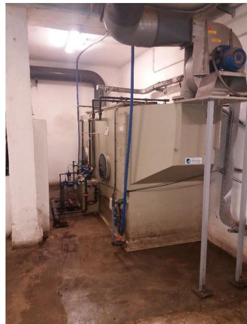
Figura 109b. Vietri. Impianto trattamento aria. Non funzionante.
