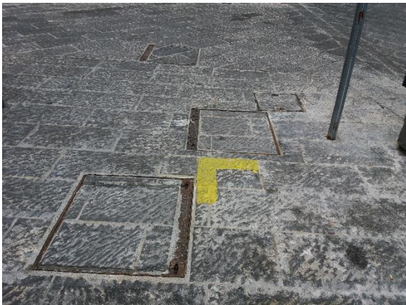
Figura 58a. Impianto Atrani via dei Dogi. Accesso alla vasca di dissabbiatura (livello 0).
