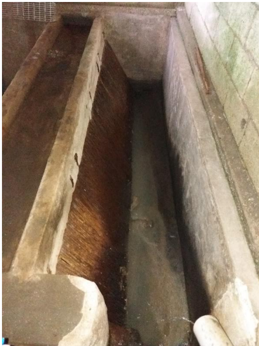
Figura 41. Impianto Praiano – Loc. Torre. Scarico in condotta.
