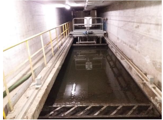
Figura 26. Impianto Positano. Dettaglio sedimentazione primaria.
