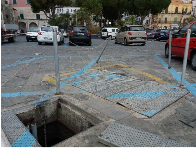
Figura 103a. Cetara. Pozzetti di accesso alla Grigliatura e dissabbiatura pompaggio
