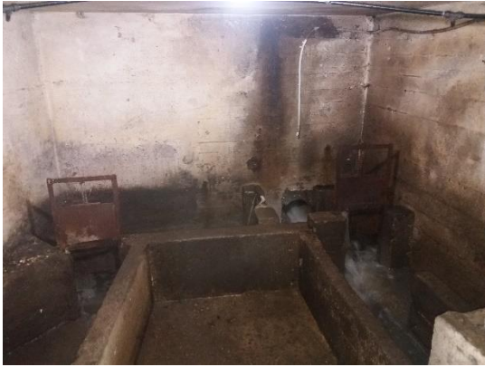
Figura 66. Impianto Ravello Marmorata. Ingresso impianto. Disinfezione.
