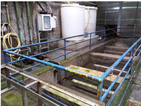
Figura 27. Impianto Positano. Disinfezione.
