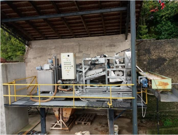
Figura 16. Impianto Agerola. Nastropressa. Inutilizzata.
