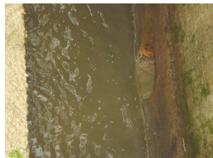
Figura 94. Impianto Tramonti. Sfioratore. In caso di pioggia i reflui (sottoposti alla sola grigliatura e dissabbiatura) vengono avviati direttamente alla fase di disinfezione.
