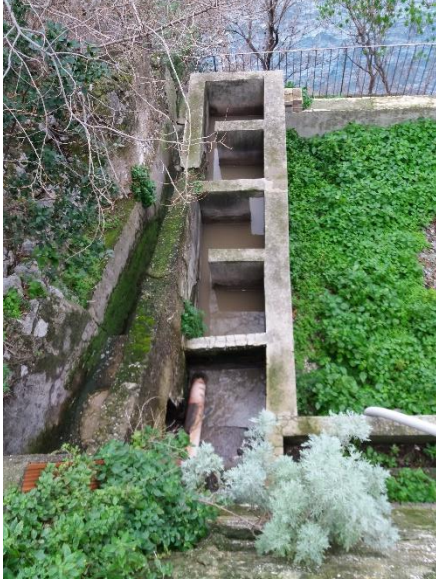
Figura 36. Impianto Praiano – Vettica Maggiore. Clorazione.
