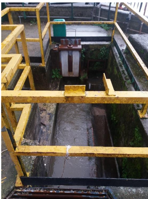
Figura 6. Impianto Agerola. Ingresso reflui. Sulla destra lo sfioro che convoglia i reflui al torrente Penise.
