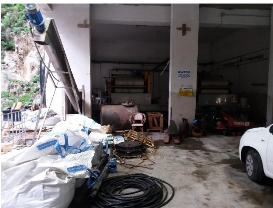
Figura 29. Impianto Positano. Nastropresse. Non utilizzate
