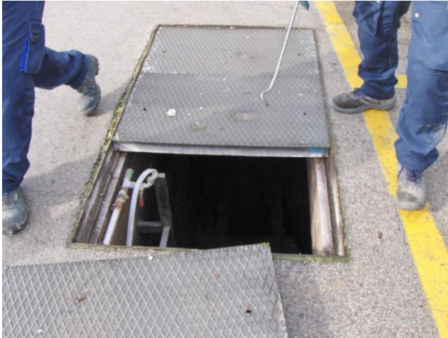
Figura 55a. Atrani Piazzale Marinella. Accesso all'impianto di pretrattamento.
