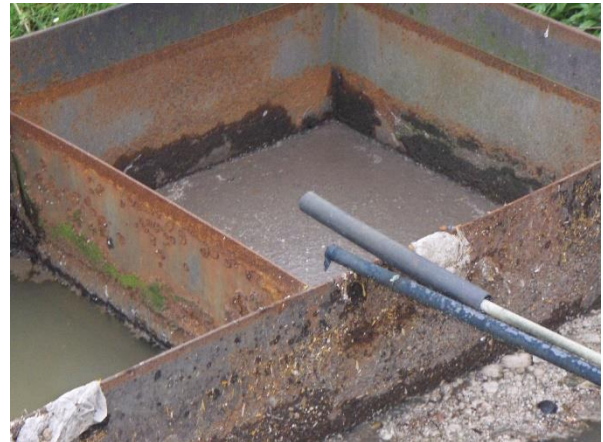
Figura 75. Impianto Ravello Sambuco. Disinfezione.
