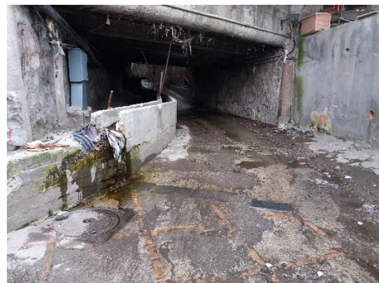
Figura 30d. Sfioro impianto sollevamento Marina Positano. In basso a sinistra il pozzetto di sfioro.
