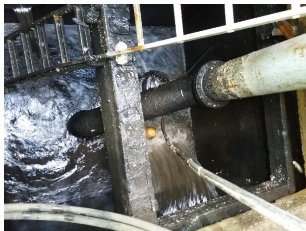
Figura 99c. Figura 99c. Maiori Corso Reghinna. Vasca raccolta acqua fiume e pompaggio. In basso a destra il flusso del fiume in arrivo nella vasca.
