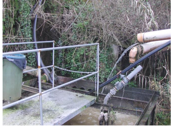
Figura 73. Impianto Ravello Sambuco. Dettaglio ingresso impianto. Dai tubi arancioni pervengono i reflui da trattare.
