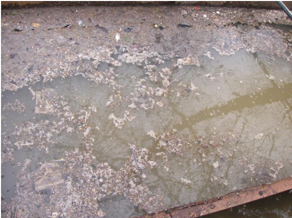
Figura 74. Impianto Ravello Sambuco. Dettaglio vasca sedimentazione.
