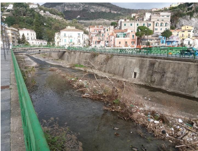
Figura 110. Vietri. Foce del fiume Bonea. Sulla riva destra lo sfioro della stazione di sollevamento.
