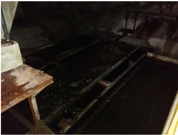
Figura 84. Impianto Minori. A sinistra la vasca (imohff) di laminazione (dotata di sfioro in condotta) e a destra la vasca dei fanghi di supero
