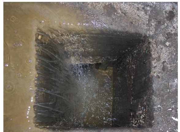
Figura 69. Impianto Ravello Marmorata. Scarico impianto.
