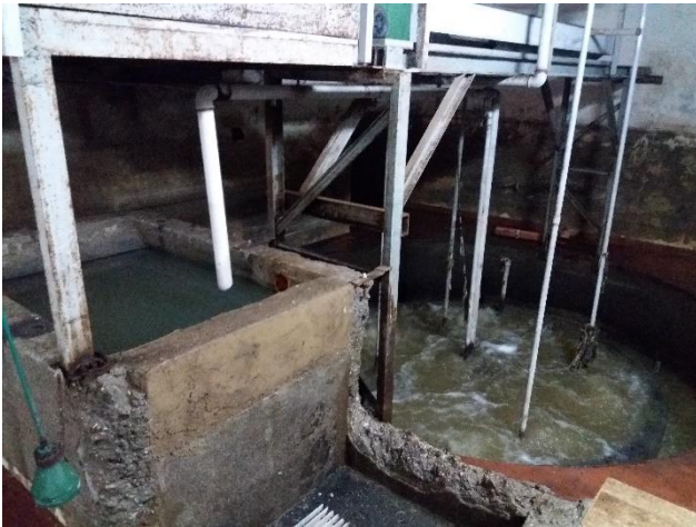
Figura 96c. Maiori Costa D'Angolo. A destra la vasca circolare di ossidazione e sedimentazione. A sinistra un'ulteriore vasca di sedimentazione.
