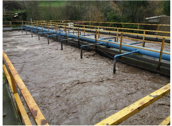
Figura 11. Impianto Agerola. Vasca di ossidazione.
