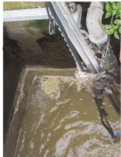
Figura 63. Impianto Ravello Cigliano. I reflui in uscita dall'impianto sono raccolti in una vasca e tramite pompa immessi in fognatura.
