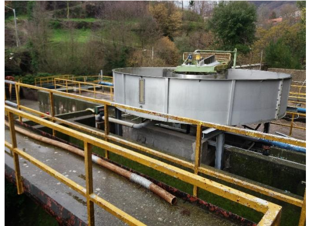
Figura 17. Impianto Agerola. Degrassatore. Non utilizzato.
