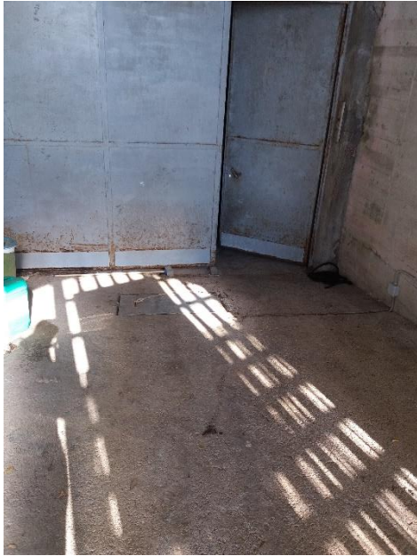
Figura 48a. Impianto pretrattamento Furore. Accesso tramite la botola.
